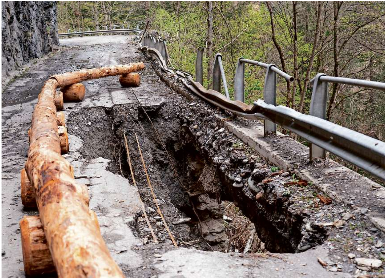
Den schlechten Zustand dokumentiert: Pius Furgers Aufnahmen vom Strassenabschnitt im Verlorenen Loch bei Thusis haben für einige Reaktionen gesorgt. Bild Pius Furger
